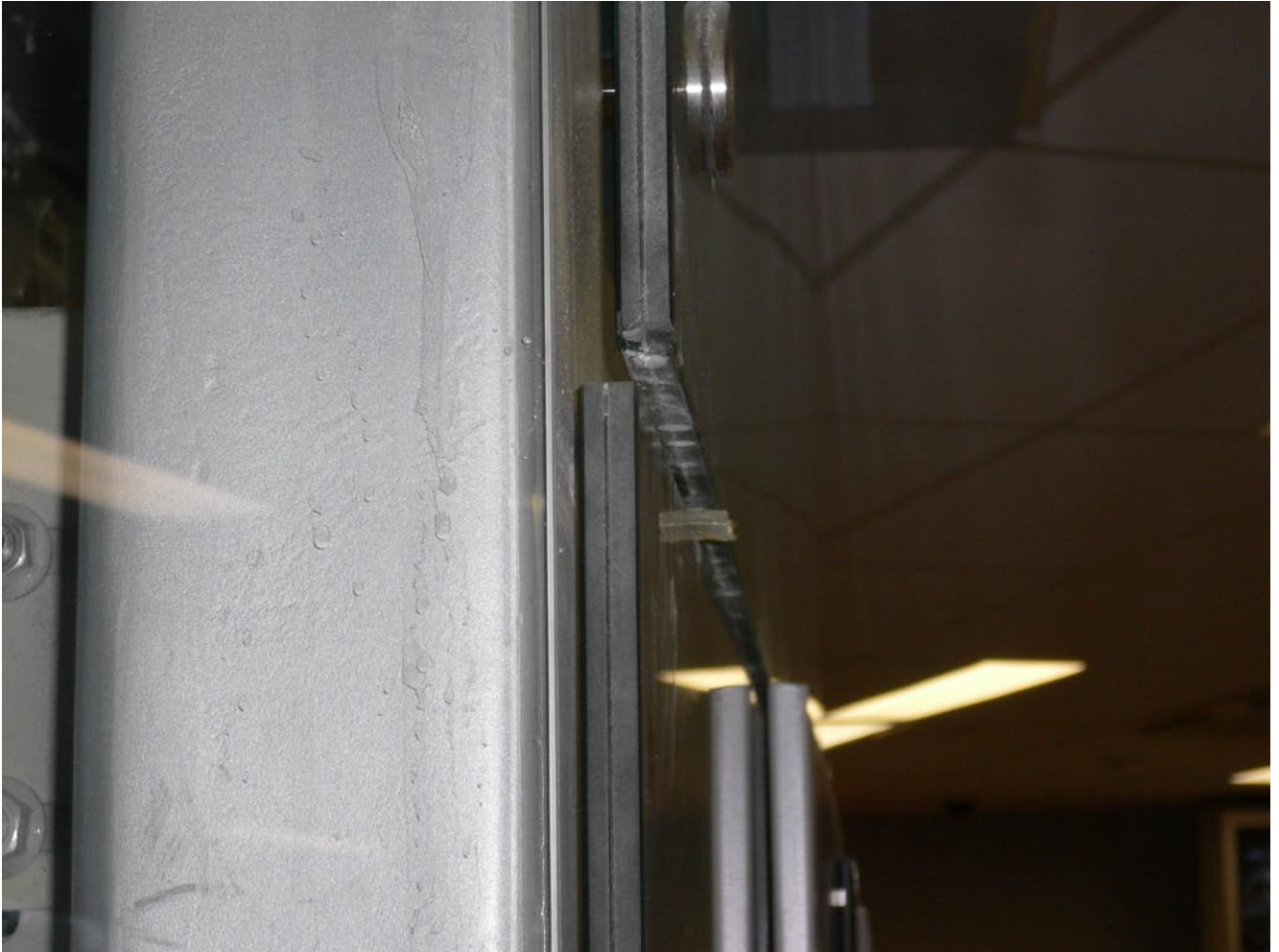
Рис. 3 Какому заказчику понравится такой монтаж остекления?
