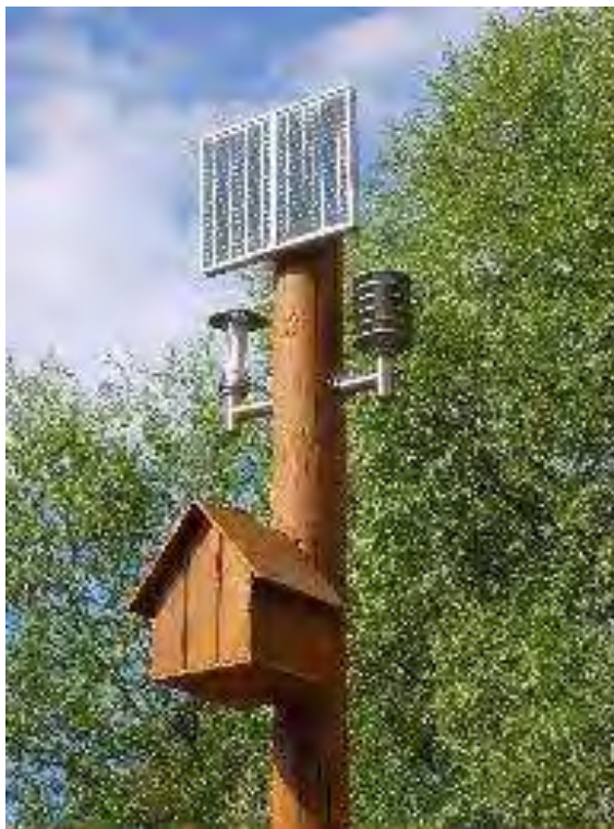
Рисунок 1. Освещение с использованием светодиодных ламп и солнечных батарей. Экологический парк, Москва
